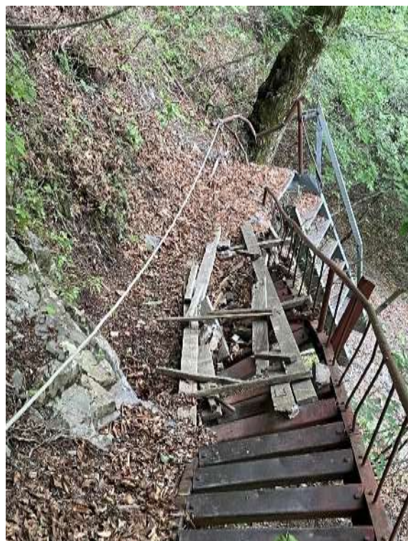
ウソッコ沢小屋先階段の破損
